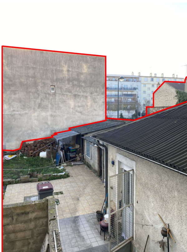
PC27-A2-10 – Vue depuis l'intérieur de l'îlot, à l'angle des deux avenues Jean Jaurès et Maurice Berteaux
