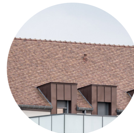
Revêtement de toiture en tuile néoplate teinte chevreuse et lucarne en zinc, teinte marron
